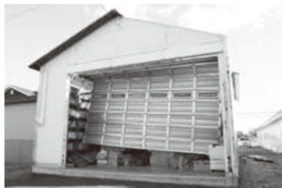
破損した役場書庫
