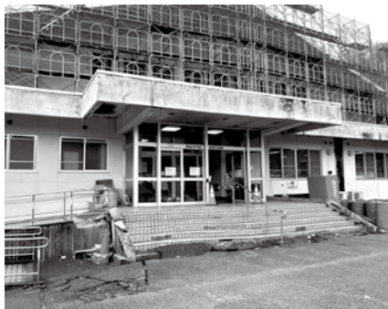
拠点となっていた輪島市の門前健民体育館。建物のあちこちに応急措置の修繕が施されていました。他の多くの施設にも、傾きがみられました。
