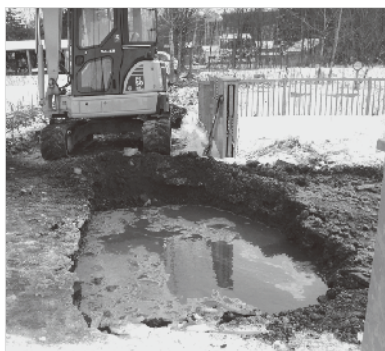
水道管破損による漏水の水たまり
