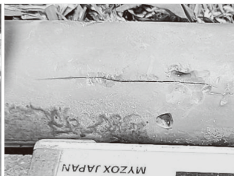
老朽化して破損した水道管
