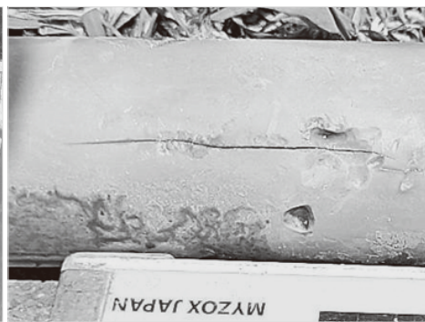
老朽化して破損した水道管
