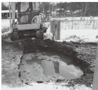
水道管破損による漏水の水たまり
