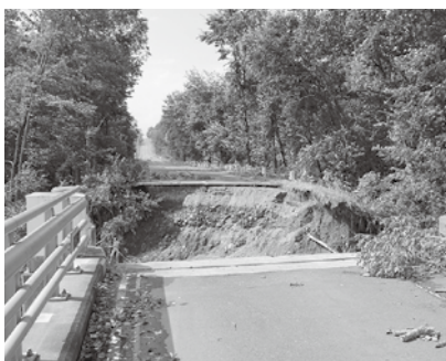
崩落した戸蔭大橋
