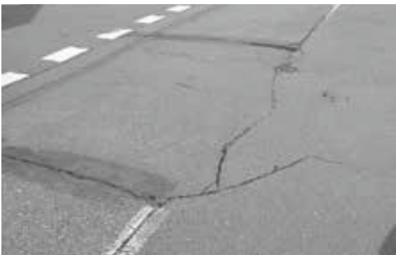
市街地舗装道路で見られるひび割れ
