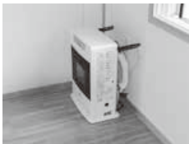
ふれあい団地に設置された暖房機
