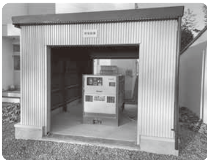
上札内交流館に設置されている 非常用発電機
