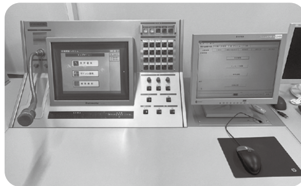
導入後14年が経過し不具合が出ている操作卓
