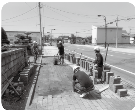
村道の歩道については年ごとに予算をつけて修繕する予定
